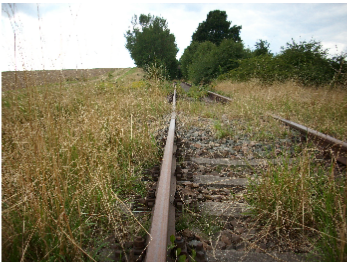
Illegale Überquerungen mit schweren Landwirtschafts-, oder Forsttechnischen Gerät sorgen für hohen Schaden und einer teuren Ertüchtigung der Gleisanlagen. Bild: Archiv-AG-Bahnpost:
